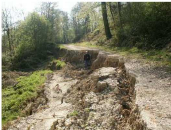
Amont du glissement : dans la forêt
