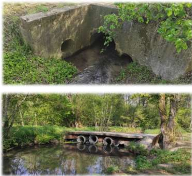
Figure 103 : Exemple d'ouvrages de franchissement routier ou agricole problématique
